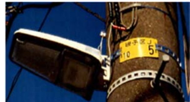
図12 電柱共架型防犯灯
